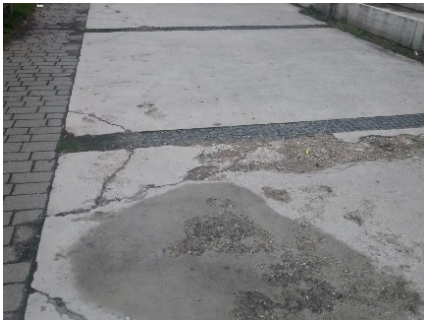
Schäden am Belag
